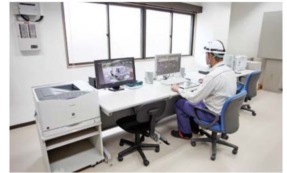
中央監視制御室
